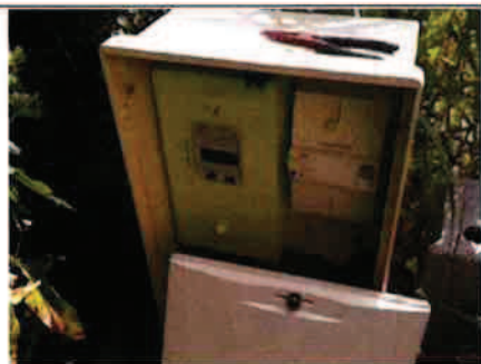
Photo du Compteur électrique
