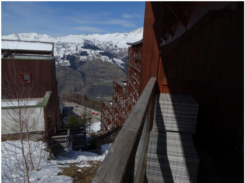
Le sol du balcon est en bois dont une latte est cassée.
