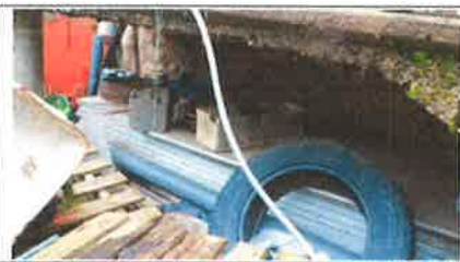
Photo n° PhA001 Localisation : Escalier extérieur Ouvrage : Murs, Cloisons "en dur" et Poteaux (périphériques et intérieurs) Partie d'ouvrage : Entourages de poteaux (amiante-ciment) Description : Entourage poteau en amiante ciment - Sous palier escalier Localisation sur croquis : P1
