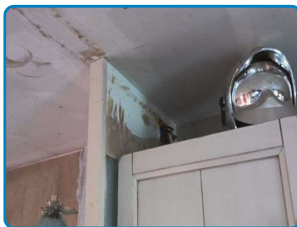
Anomalie B.7.3 d sur Install. n°1
