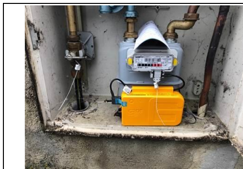
Photo n° du Compteur Gaz
