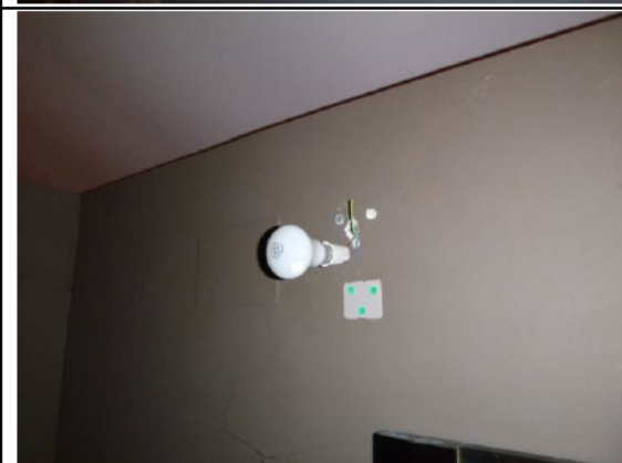
Photo PhEle003 Libellé de l'anomalie : B8.3 a L'installation comporte au moins un matériel électrique vétuste. Remarques : Présence de matériel électrique vétuste (douilles, interrupteurs, socles de prise...) ; Faire intervenir un électricien qualifié afin de remplacer les matériels électriques vétustes.
