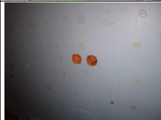
Photo PhEle002 Libellé de l'anomalie : B7.3 d L'installation électrique comporte au moins une connexion avec une partie active nue sous tension accessible. Remarques : Présence de connexion de matériel électrique présentant des parties actives nues sous tension ; Faire intervenir un électricien qualifié afin de remplacer les matériels présentant des parties actives nues sous tension.
