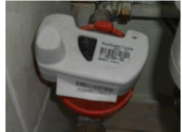
Compteur d'eau chaude individuel
