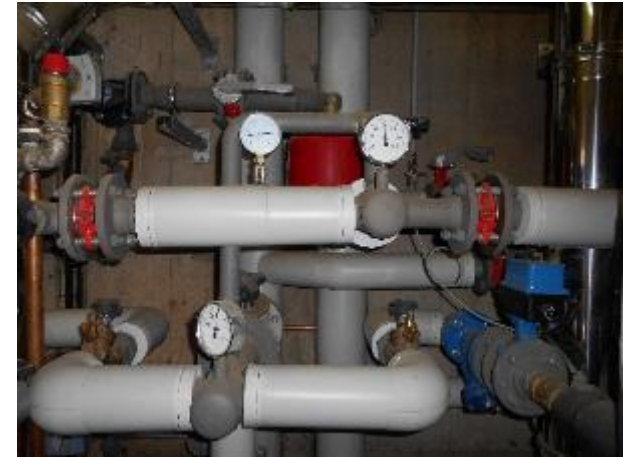
Départ général chauffage
