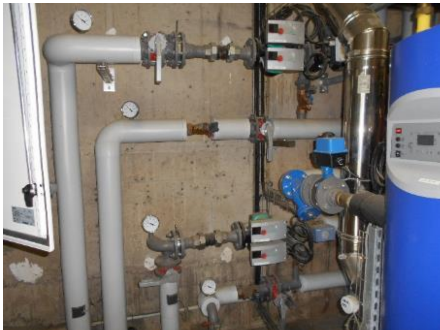
Calorifugeage en chaufferie
